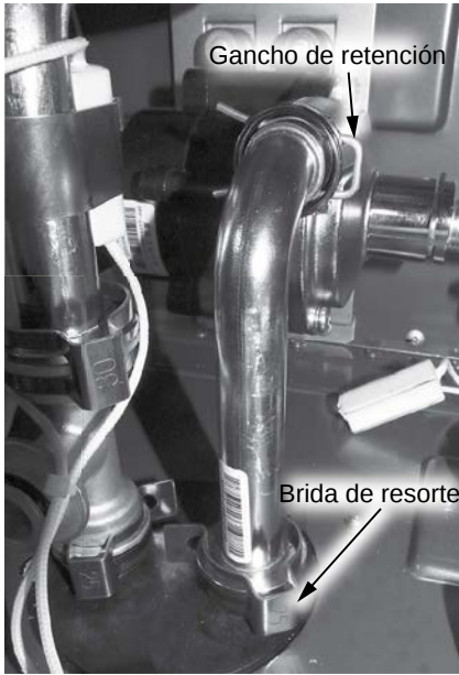
Figura 185 - Ubicación del tubo de salida de la bomba.
