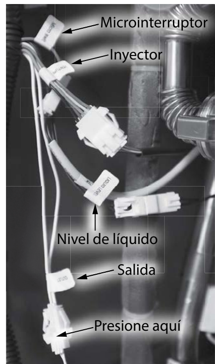
Figura 49 - Tercer mazo de cables.
