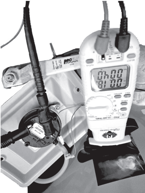
Figure 6. Essai du manocontakt d'évacuation
